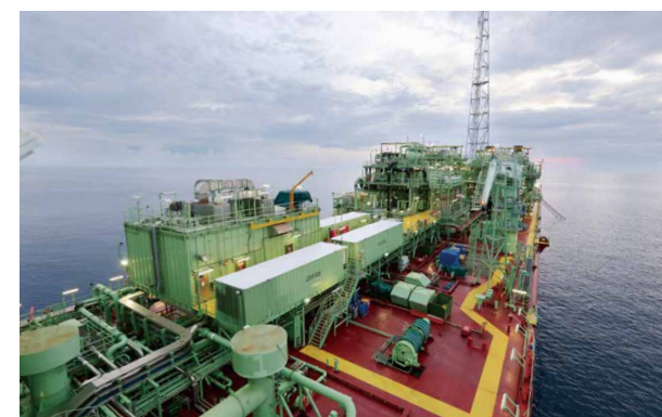
△ 洋上ガス処理設備
